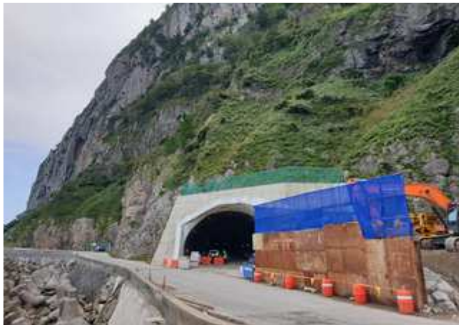
낙석방지펜스 설치 현황
